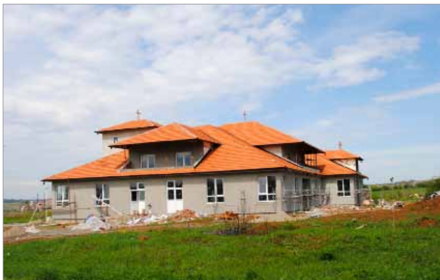
Приводе се крају радови на изградњи модерне предшколске установе у Населу Гај
