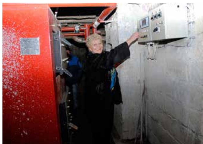
За грејање Дома набављен најсавременији котло на пелет
