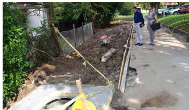
Сређена кишна канализација код Дома здравља
