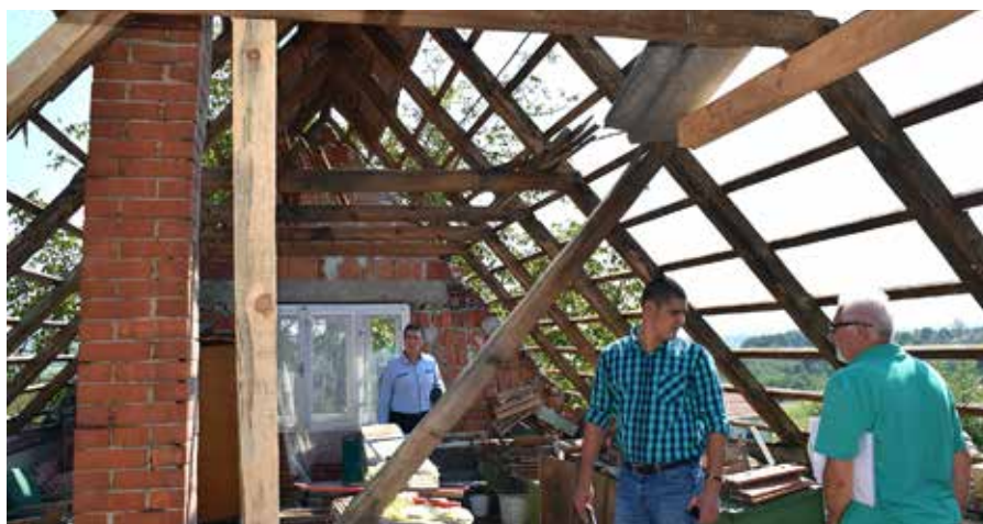
Председник општине са сарадницима обишао оштећене објекте
