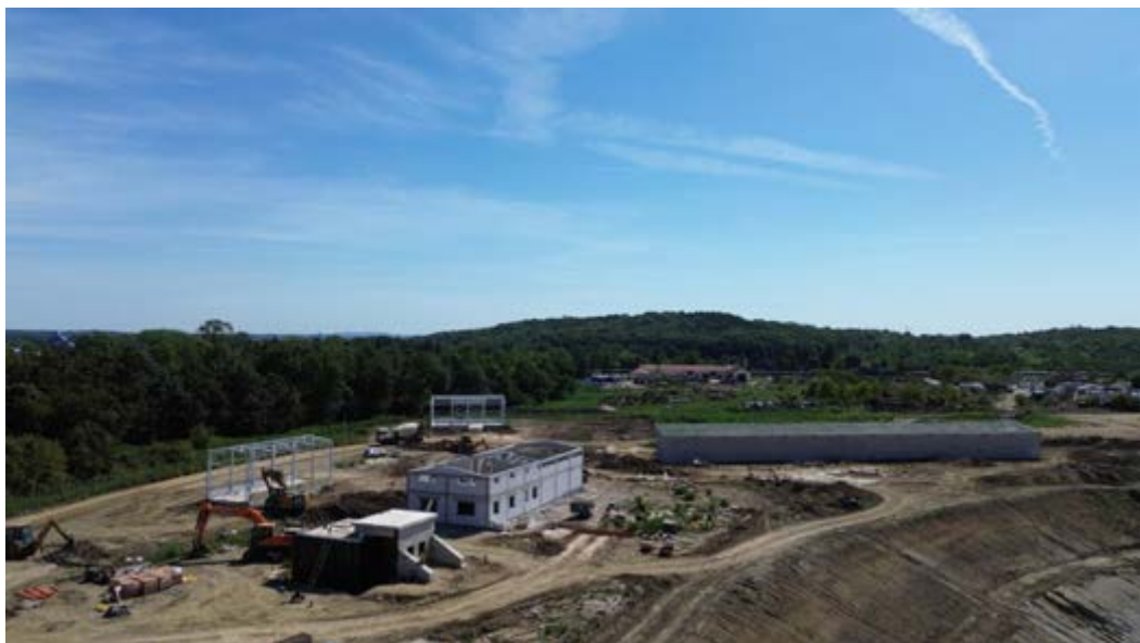
Слика 4.8.1-2. Пресек радова на изградњи објеката на комплексу РЦУО „Каленић“ - I фаза (август 2024.година)
